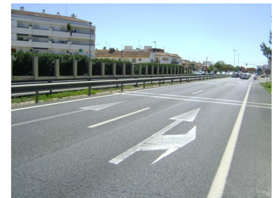
Vista de la calzada derecha y del estado del pavimento a la altura del PK 3+650
