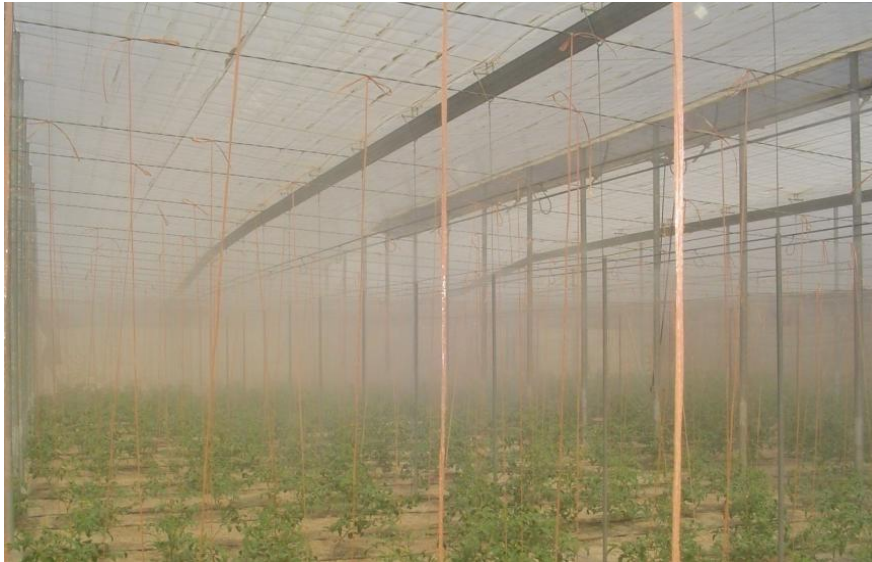
Figura 6. Instalación de pulverización neumática en un invernadero.
