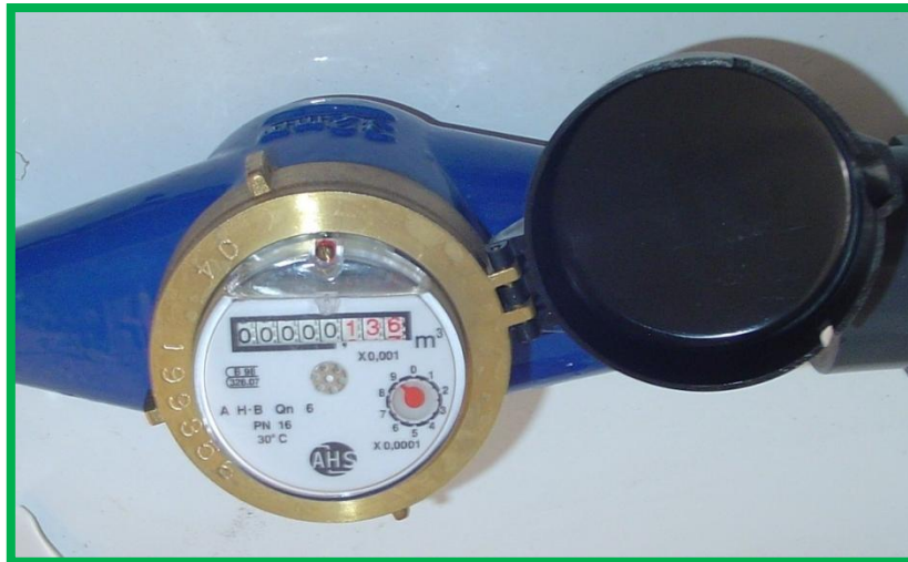
Caudalímetro mecánico instalado en una instalación fija de pulverización neumática.
