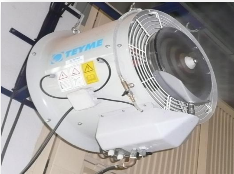
Instalación fija de pulverización centrífuga.
