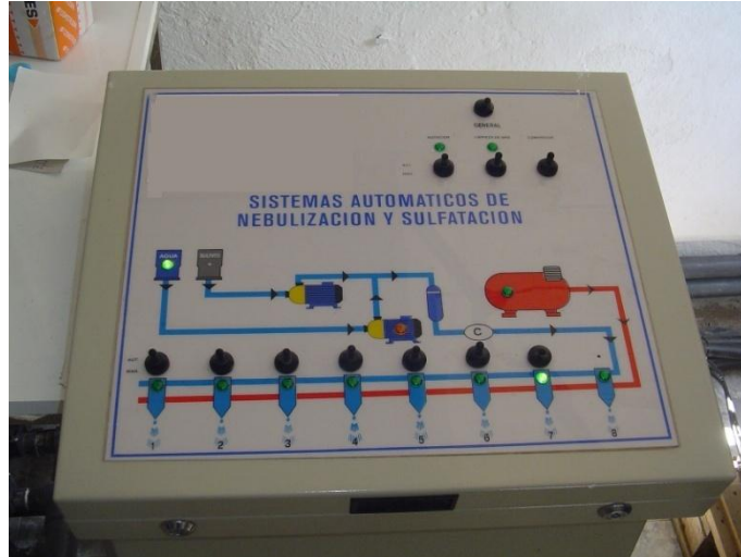
Figura 4. Centralita electrónica que gobierna un sistema fijo de nebulización en un invernadero.
