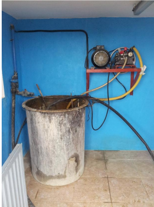
Unidad de impulsión (depósito y bomba)
