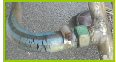
Figura 28. Tubería agrietada que puede dar lugar a fugas.
