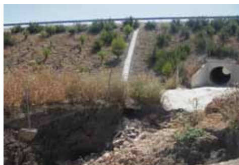
Figura 6. Cráava iniciada por un desagüe de carretera mal finalizado.
