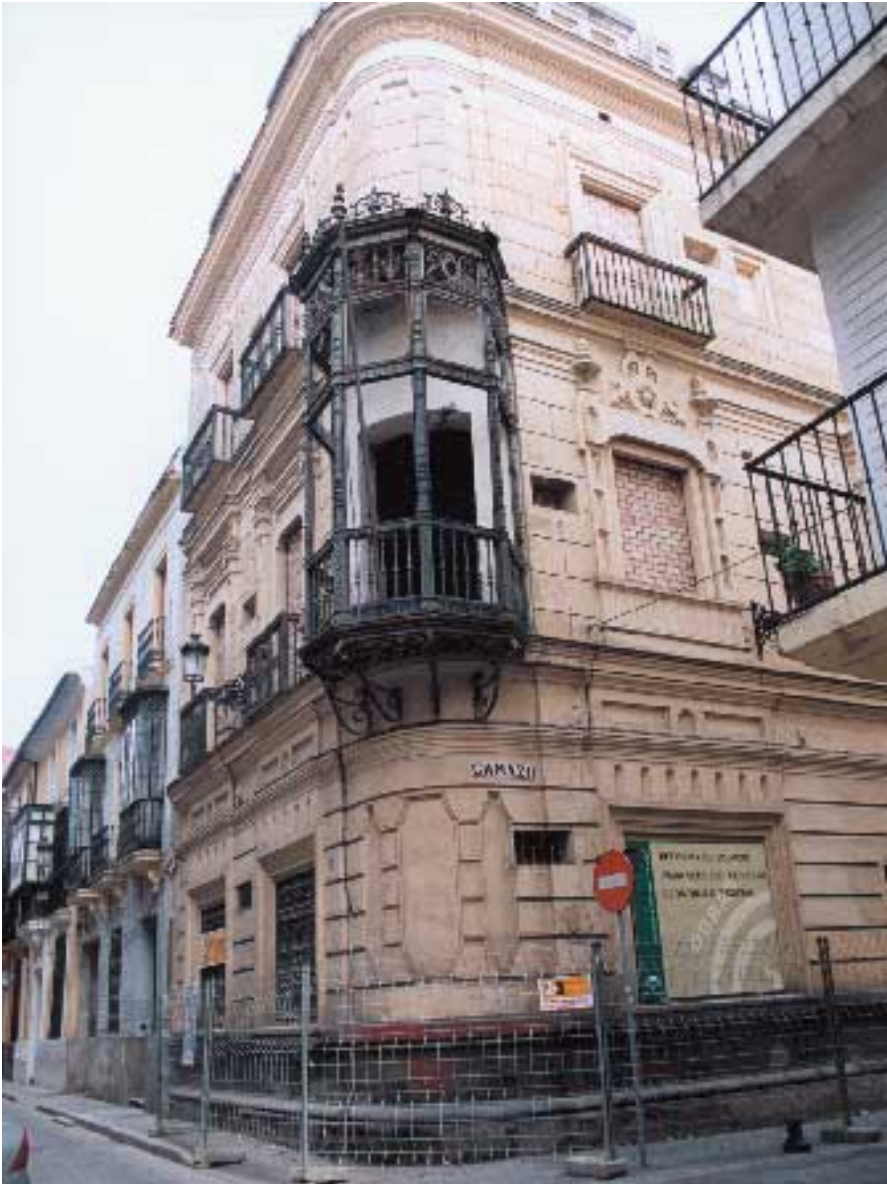
Las obras de la futura sede del Consejo Económico y Social de Andalucía ya están en marcha
