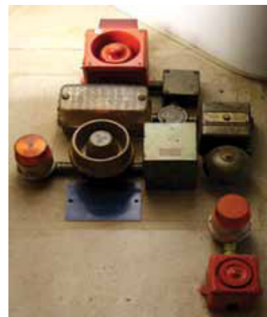
Figura 17. Sistemas de alarma
