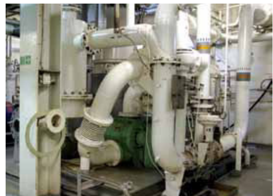
Figura 25. Generador/Planta de gas inerte a bordo
