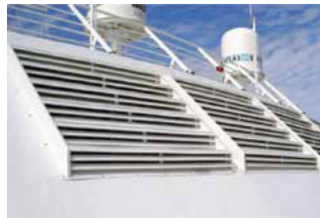
Figura 30. Sistemas de ventilación
