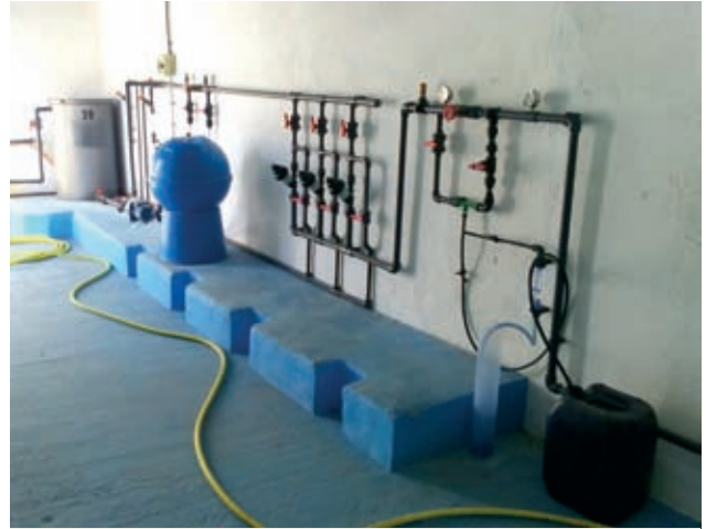
Figura 6. Cabezal de riego en el interior de una caseta
