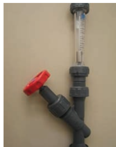
Figura 2. Caudalímetro y válvula de regulación
