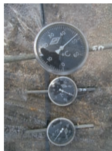
Figura 7. Termómetros instalados para el registro de la temperatura del suelo
