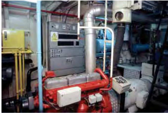
Figura 3. Sala de máquinas
