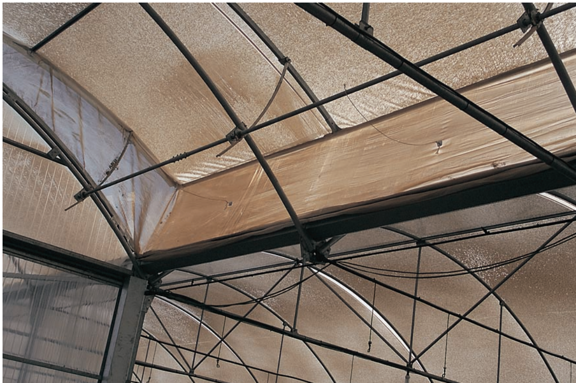
Foto. 4. Ventilación cenital en un invernadero de cubierta semicircular.
