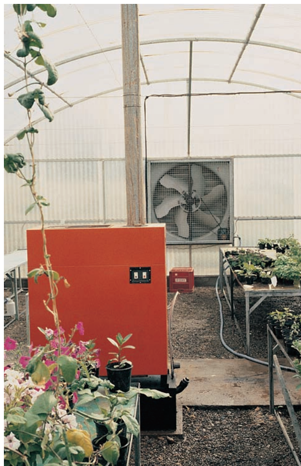
Foto 8. Generador de agua caliente
