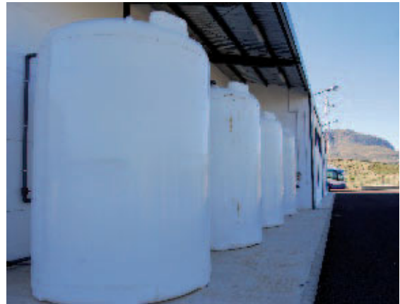
Figura 7. Depósitos para fertirrigación en una Comunidad de Regantes. Es conveniente disponer de varios depósitos para evitar reacciones entre fertilizantes
