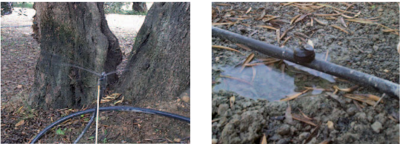
Figura 1. La mayoría de las instalaciones de riego de olivar son localizadas, principalmente riego por goteo, con goteros, pinchados, integrados o enterrados. En algunos casos el emisor es un microaspersor o un microdifusor
