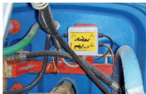
Figura 5. Señalización de peligro del eje de transmisión
