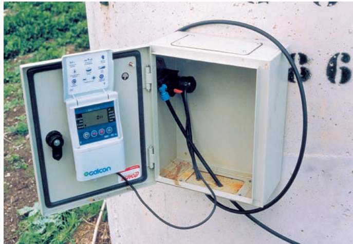
Figura 10. Programador de riego para una automatización sencilla del riego.
