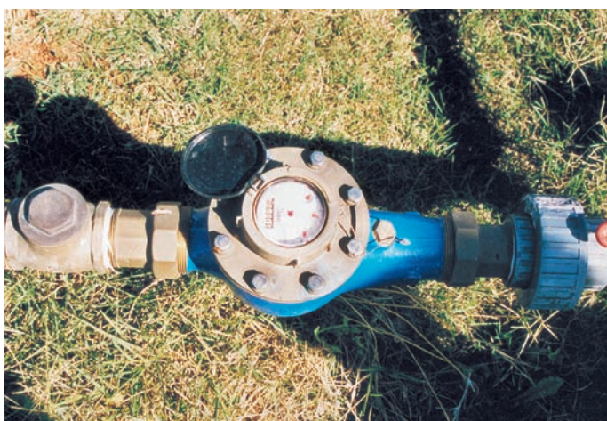
Figura 9. Contador instalado en una acometida.
