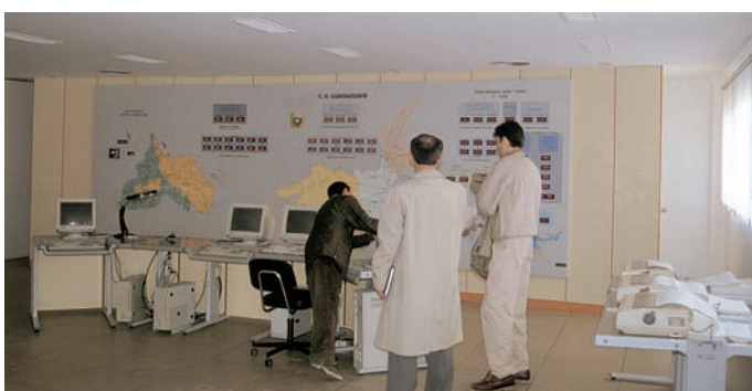
Figura 2. Puesto de control de una comunidad de regantes.
