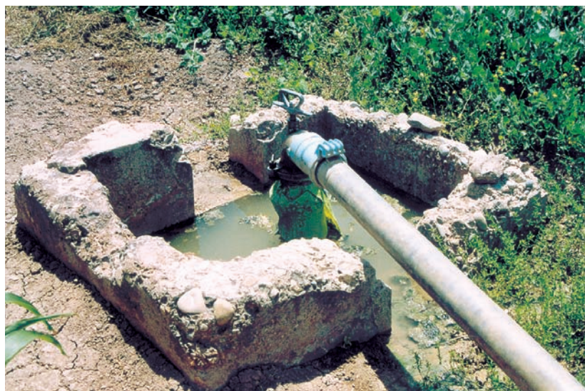
Figura 10. Toma o boca de riego, también denominada "hidrante".
