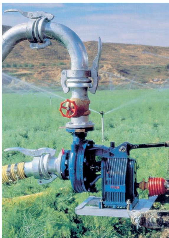
Figura 7. Grupo motobomba. Pueden observarse la tubería de aspiración, la tubería de impulsión y en la parte derecha, el enganche a la toma de fuerza de un tractor.
