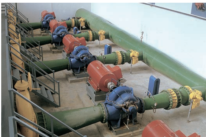
Figura 3. Impulsión del agua mediante un gran sistema de bombeo en una zona regable. Puede observarse la disposición de las bombas en paralelo.
