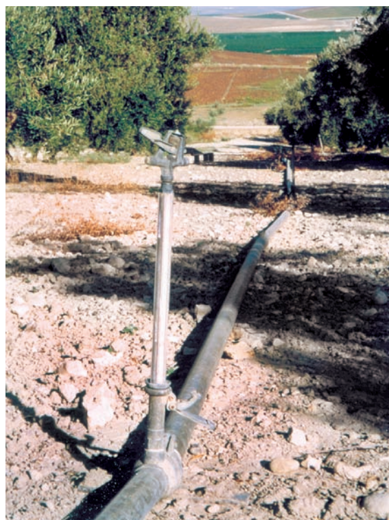
Figura 8. Tubo portaaspersor dotado de un acople rápido al ramal de aspersión.
