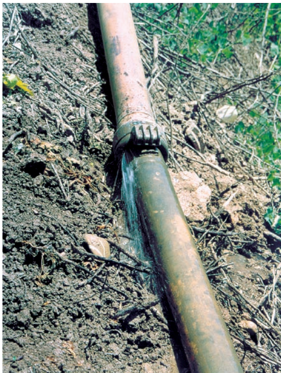
Figura 7. Unión hidráulica entre dos ramales de aspersión. Su acople ha resultado defectuoso ya que se aprecian importantes fugas de agua.
