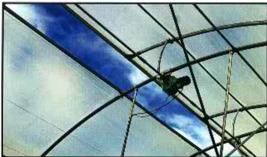
Motor de apertura de una ventana cenital en invernadero multitúnel.
