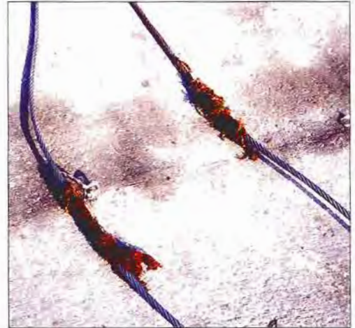
Fot. 23 - Marcas del cable
