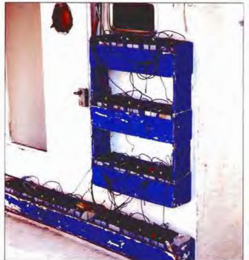
Fot. 10 - Cargador de los acumuladores de los gallos
