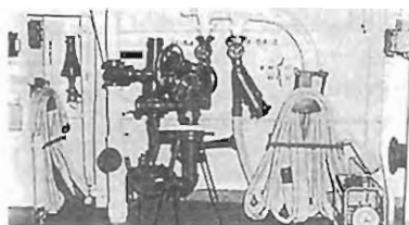
Manqueras y equipo coantrincendio estibado
