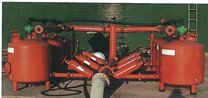
Foto 5.4 Estación de filtrado mixta, provista de filtro de arena y malla. Instalación en Posadas (Córdoba).
