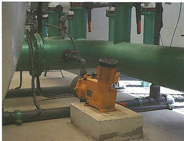
Foto 6.6 Bomba inyectora de membrana de gran capacidad de inyección en una Comunidad de Regantes de 1.500 hectáreas en Torreperogil (Jaén).
