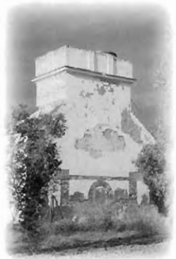
Torre contrapeso ▲ de molino de origen medieval en la hacienda Los Graneros, Sevilla.
