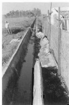
Figura 3. Canal de riego en muy mal estado de conservación.
