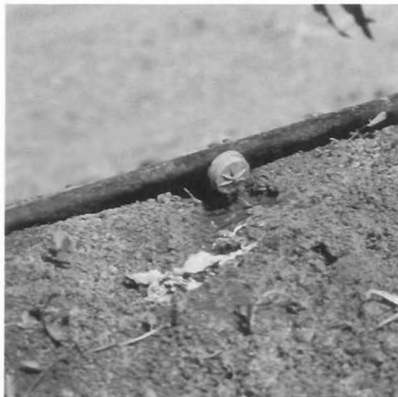
Figura 22. Gotero pinchado en una tubería lateral de riego localizado.
