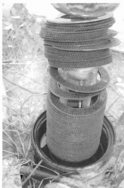
Figura 3. Limpieza de un filtro de anillas.
