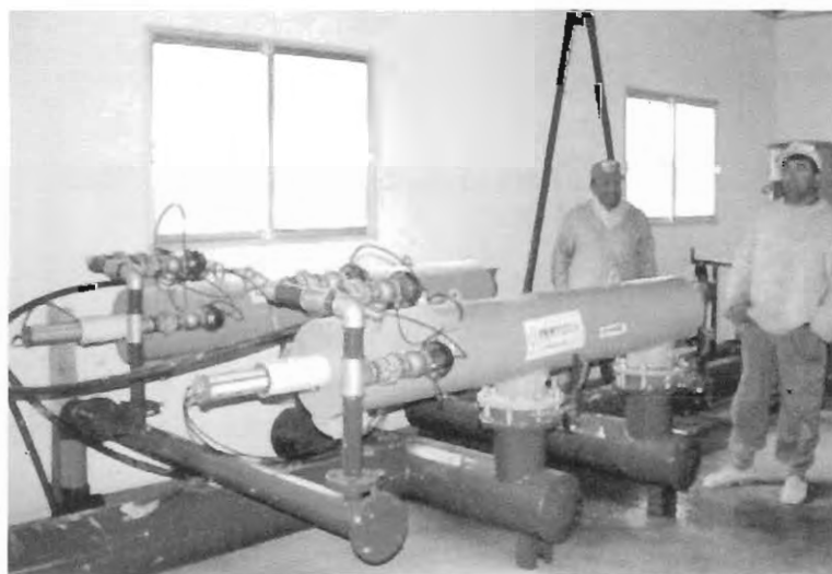
Figura 7. Batería de filtros de malla autolimpiantes.
