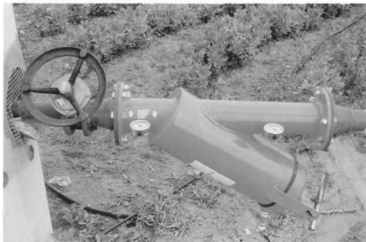
Figura 5. Filtro de malla. Obsérvese la colocación de manómetros a la entrada y salida del filtro para controlar la pérdida de presión.
