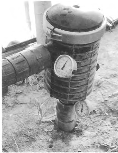
Figura 3. Medida de la presión a la entrada y salida de un filtro de anillas utilizando manómetros.
