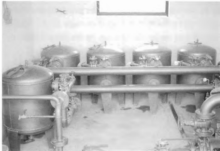
Figura 4. Batería de filtros de arena.
