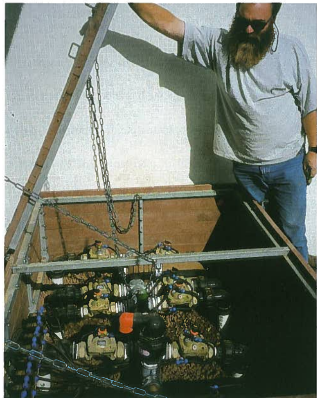
La correcta instalación de los automatismos de control y su fácil accesibilidad facilitan enormemente la conservación.
