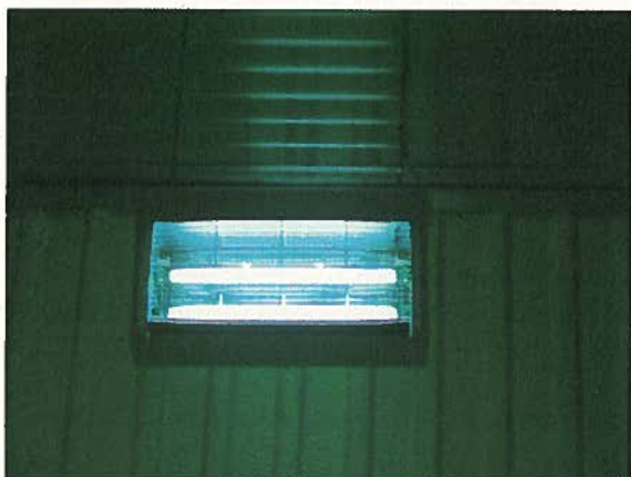
Figura 14.- Los dispositivos antiinsectos eléctricos resultan de utilidad siempre que existan medidas preventivas para la entrada de los insectos en las instalaciones.
