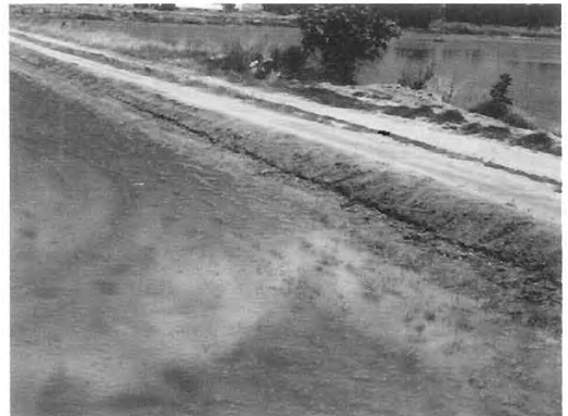
Foto 3: Daños de Gusano Rojo
