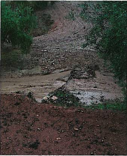
Figura 44: Sedimentación en una barrera construida con malla metálica
