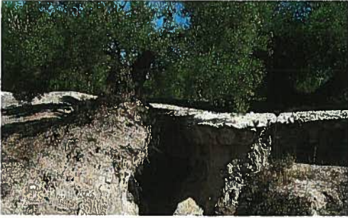
Figura 43: Socavamiento inducido por la acumulación de escorrentía debida a la cuneta de un carril
