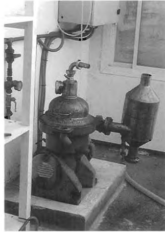
Fig. 28. Centrifuga de platos instalada en la planta experimental del CICEM "Agua del Pino"
