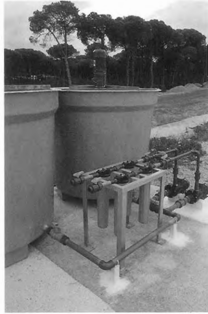
Fig. 22. Tanques de preparación de salmuera para el cultivo de Dunaliella en el CICEM de "Agua del Pino"
