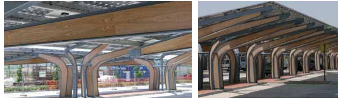
Izquierda y derecha Paneles fotovoltaicos en cubierta del aparcamiento. Parque Científico - Tecnológico Geolit en Mengíbar. Jaén.
