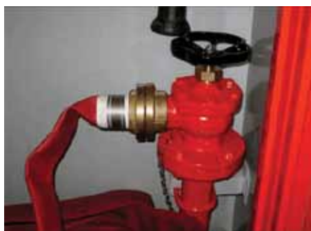
Figura 63. Bocas contra incendio
