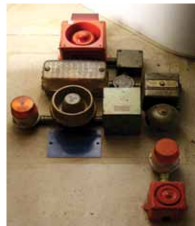
Figura 17. Sistemas de alarma
