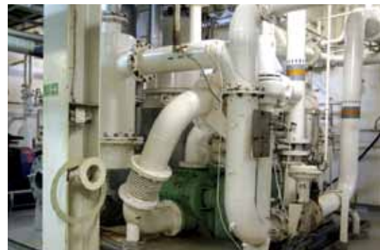
Figura 25. Generador/Planta de gas inerte a bordo
