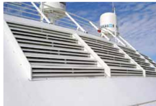
Figura 30. Sistemas de ventilación
