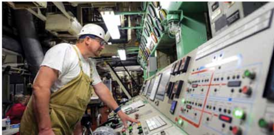
Figura 16. Control de los sistemas y alarmas
