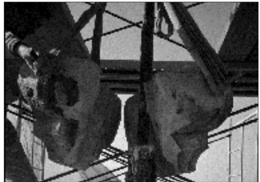
Figura 12. Detalle de los deterioros de la peana y del encuentro con la falsa linterna
