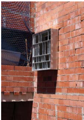
FASE DE OBRA: PATIO Y TRATAMIENTO DE FACHADAS EDIFICIO HISTÓRICO. ABAJO, DETALLE CAJA DE VENTANA.
