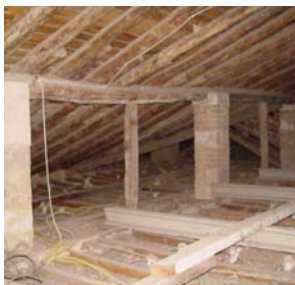
ESTADO PREVIO BAJO CUBIERTA. ESTADO FASE DE OBRA Y EQUIPO DE REHABILITACIÓN.
