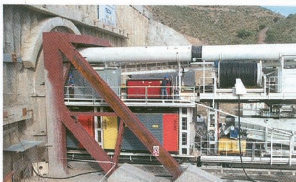
Foto 2. Estructura de reacción para iniciar la excavación del túnel. Photo 2. Reaction structure for starting the excavation of the tunnel.
