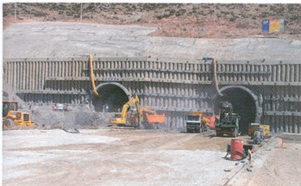
Foto 1. Vista general del emboquille sur del Túnel de Abdalajis. Pantalla de pilotes anclada/ Photo 1. General view of the south entrance of the Abdalajis Tunnel. Anchored pile screen.
