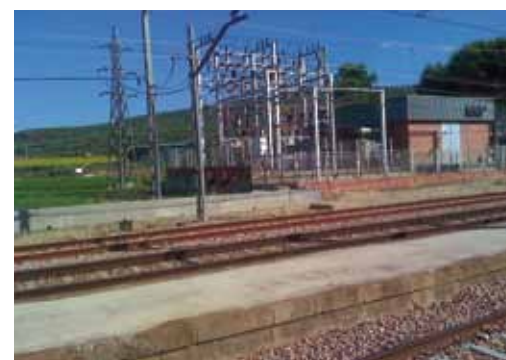
Las subestaciones eléctricas, necesarias para la alimentación de la línea férrea, pueden formar parte, mediante una correcta integración con el resto de elementos, de un buen paisaje ferroviario
