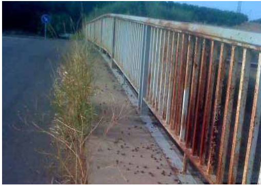
Un caso frecuente: el paso de una carretera local sobre las vías con un acerado deficiente que interrumpe una posible continuidad peatonal. Inmediaciones de Posadas
