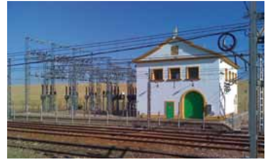
30. Pedro Abad. Subestación eléctrica de los años 50
