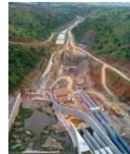
186. Almodóvar del Río. La presa de la Breña II sobre el río Guadiato
