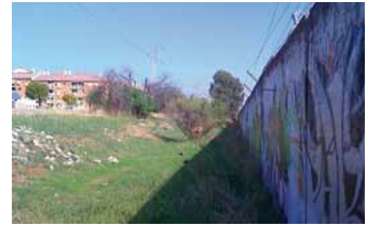
Es necesario sustituir esta tapia. Su longitud y situación causan una deplorable imagen
