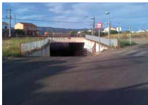
Un paso feo, peligroso. Improvisación sin el más mínimo estudio previo
