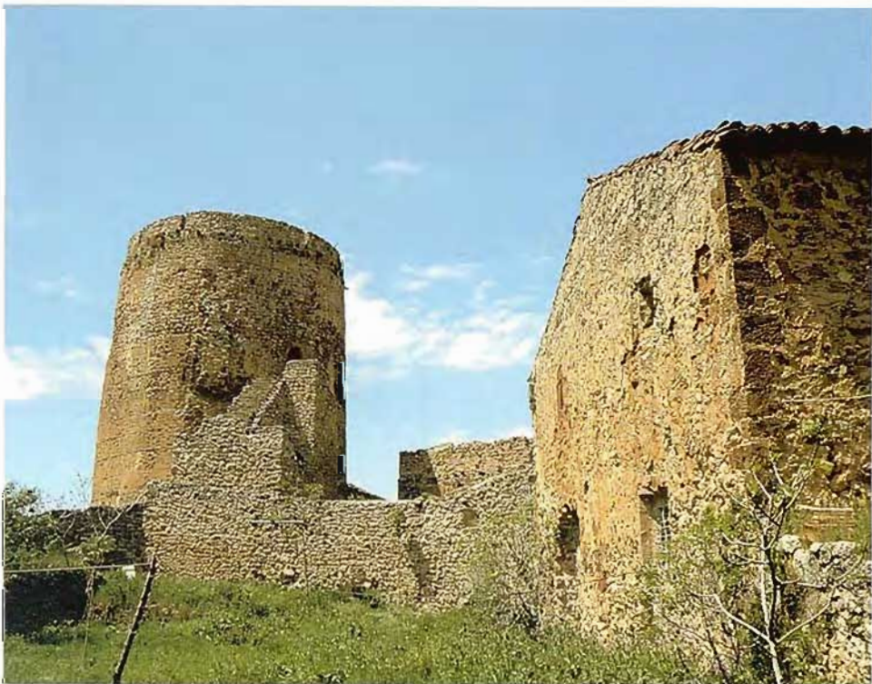
Vista general de la casa tercia y alzado lateral junto al «Cubo».
