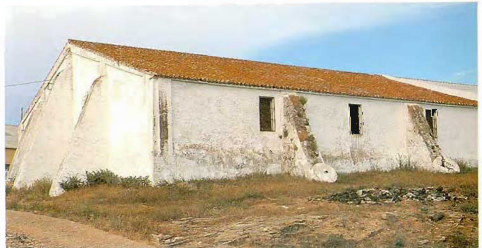
Vista exterior del pósito donde destacan los potentes contrafuertes. Arriba, detalle del interior y portada.
