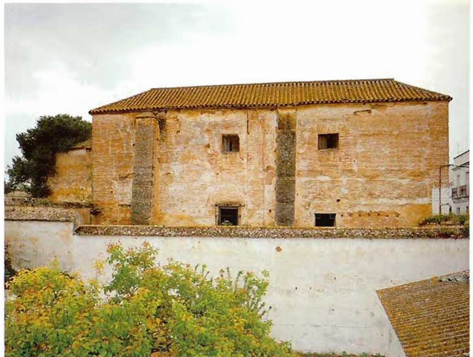
Fachada principal en la que sobresalen los volúmenes de las dos naves de almacén y vista exterior de una de ellas.
