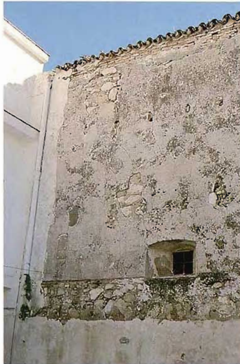
Testero de la nave de almacén y detalle del muro lateral, integrado como medianería dentro del casco.
