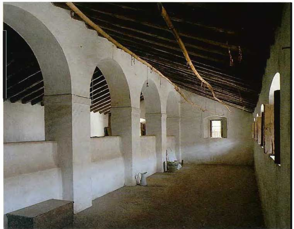
Fachada de la cilla de Bollullos, muy transformada en la actualidad. Nave de almacén en planta alta.
