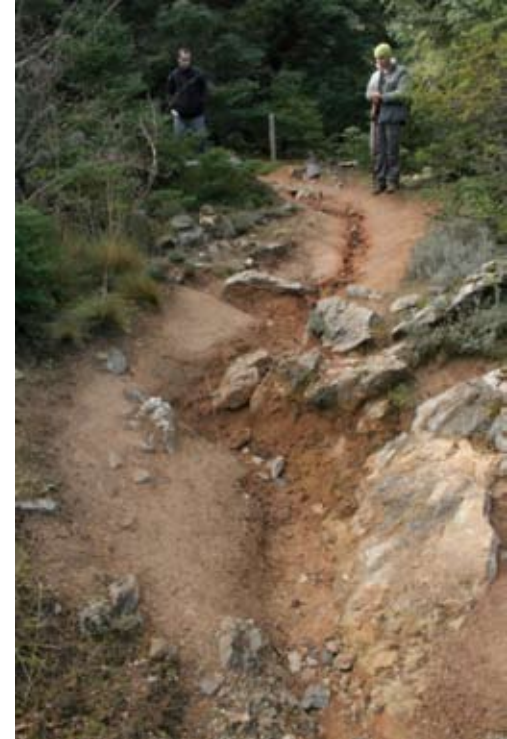
Foto 4. Deterioro del firme del sendero.
