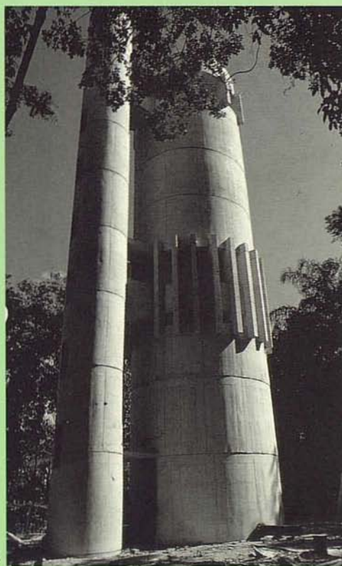
Tanque de agua.
