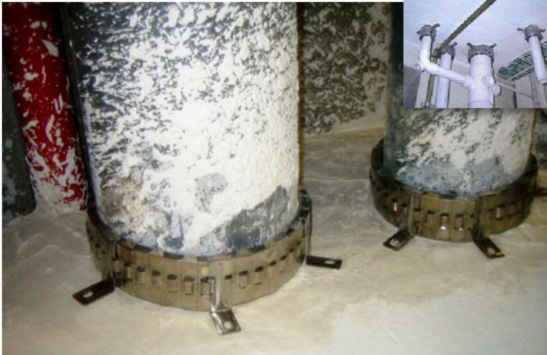
Collarines para sellar hueco de paso de tuberías de PVC a través del forjado
