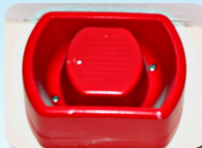
Dispositivo de alarma acústica general para movilización general y/o evacuación
