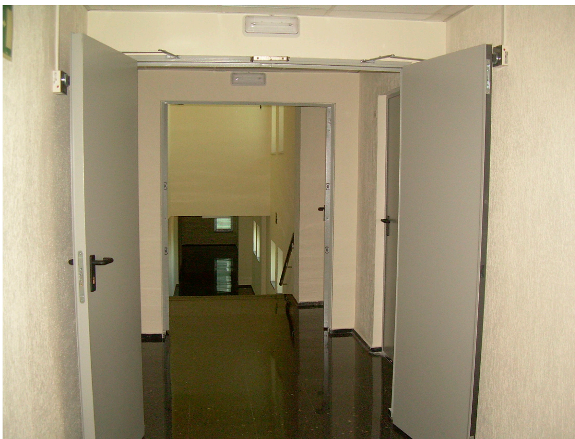
Puerta cortafuego con retenedores para mantenerla permanentemente abierta y cierre automático
