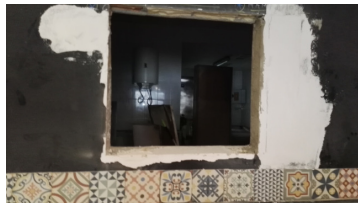
HUECO ABIERTO EN PARAMENTO
