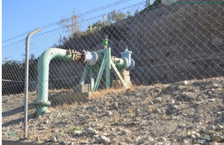
Imagen 151: Captación de aguas subterráneas en Santa Fe de Mondújar.
