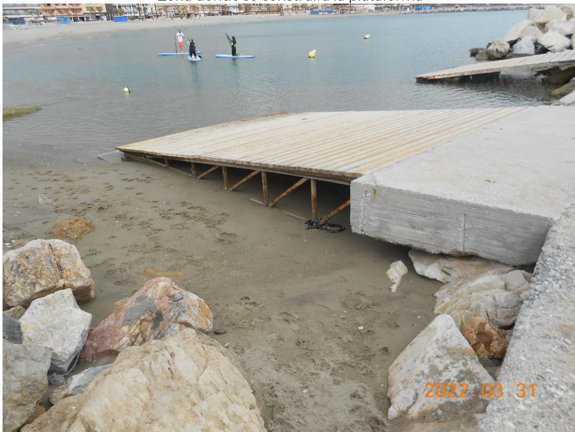
Rampa fija actual a desmontar. Desnivel a salvar.
