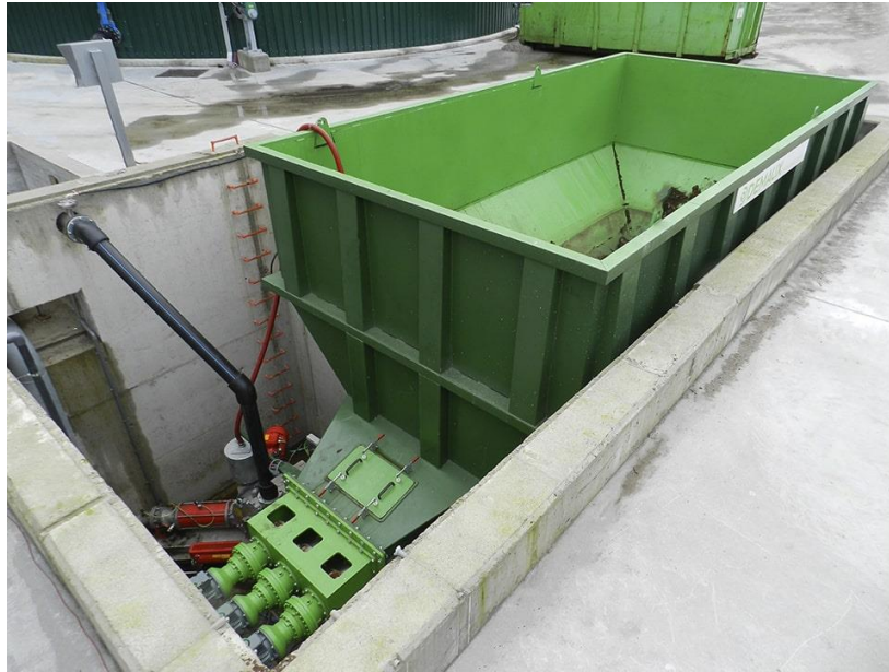
Ilustración 7-1. Tolva de recepción con tornillos de extracción (Propio)
