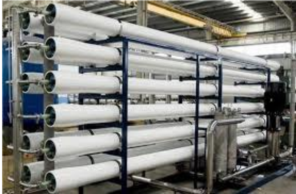
Ilustración 4-27: Instalación de ósmosis inversa.
