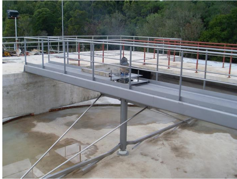
Ilustración 4-8. Sistema de separación de arenas (Propio)
