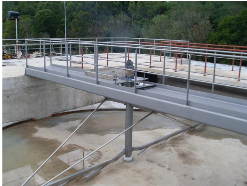
Ilustración 7-5. Sistema de separación de arenas (Propio)
