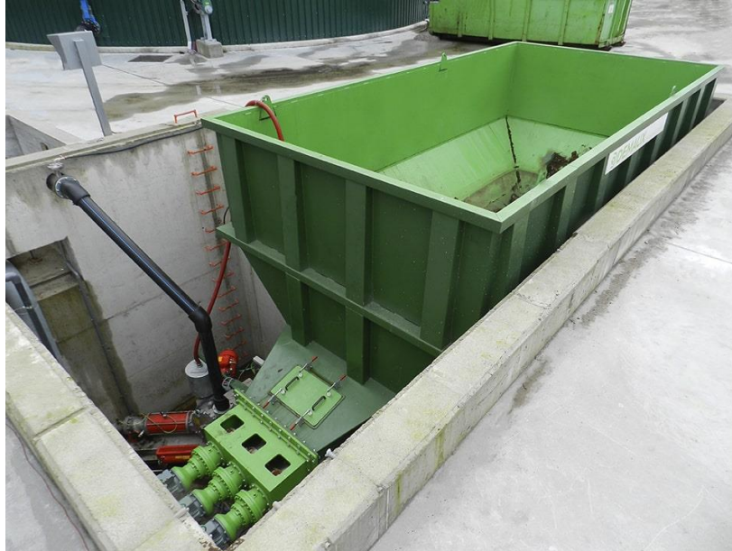
Ilustración 4-3. Tolva de recepción con tornillos de extracción (Propio)
