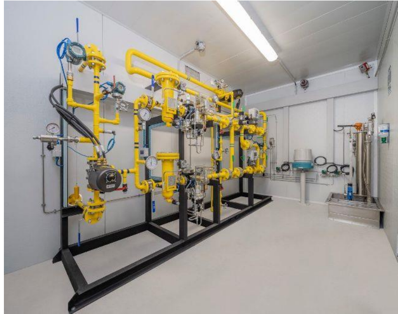
Ilustración 4-18. Módulo de inyección a red (Propio)
