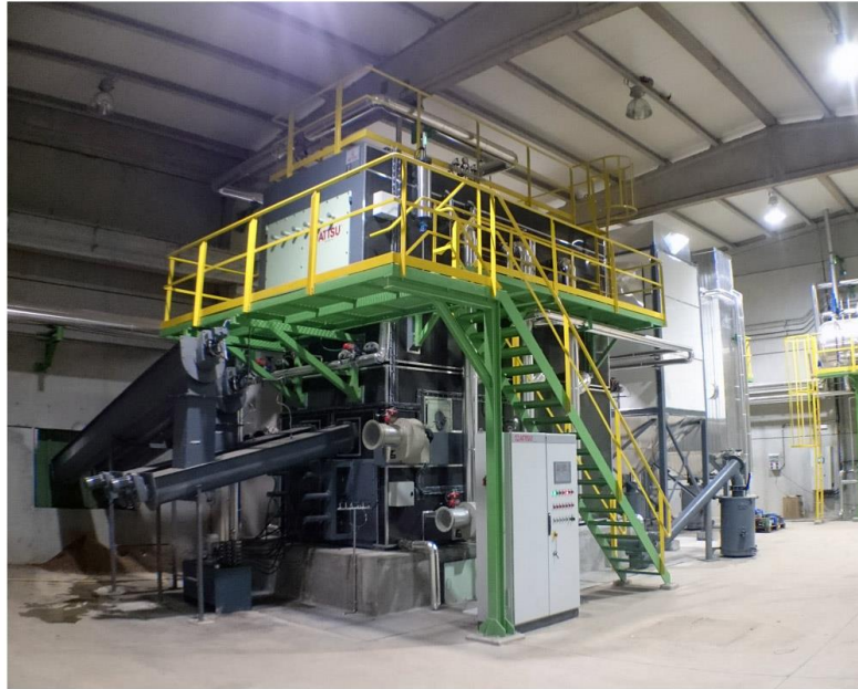
Ilustración 4-12. Caldera de biomasa (Propio)
