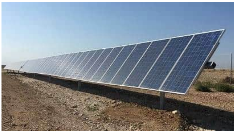
Imagen 22. Seguidor solar tipo.
