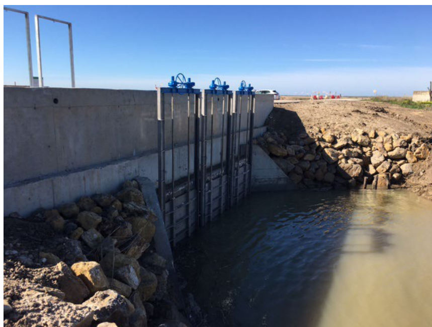
Imagen 11. Paneles de acero elevadizos
