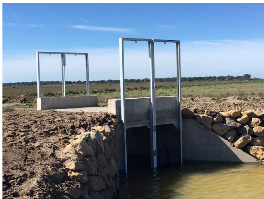
Imagen 14. Compuerta de desagüe
