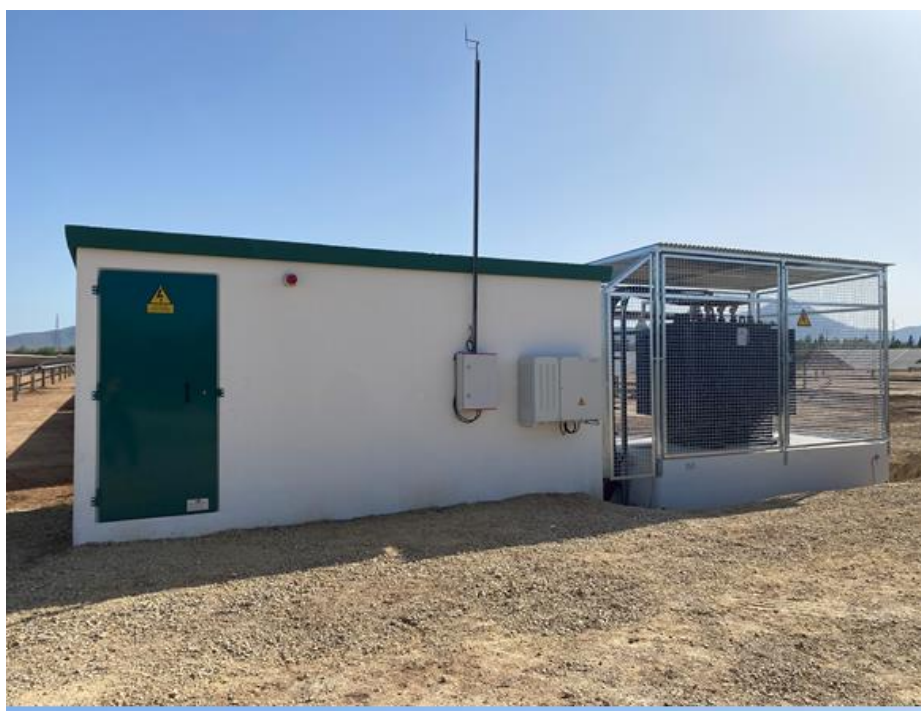
Imagen 6. Centro de transformación
