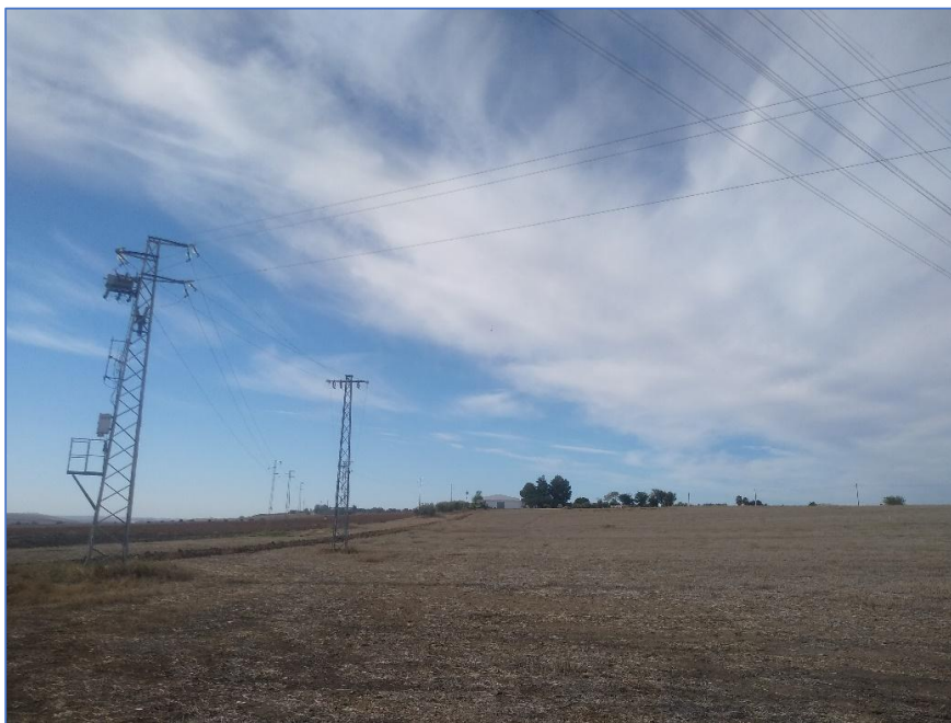
Figura 7. Apoyo de línea.
