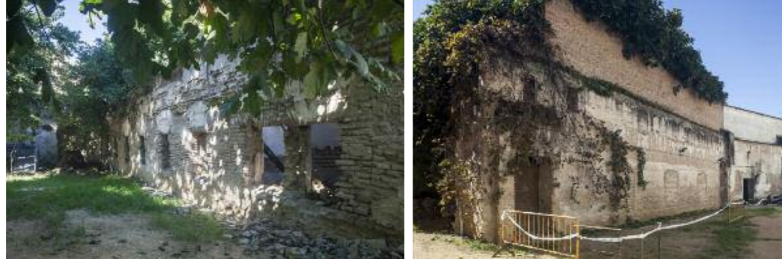
NUEVO NOVICIADO CONSTRUIDO EN EL SIGLO XIX EN EL SOLAR DE LA HUERTA: MUROS SUR Y NORTE.
