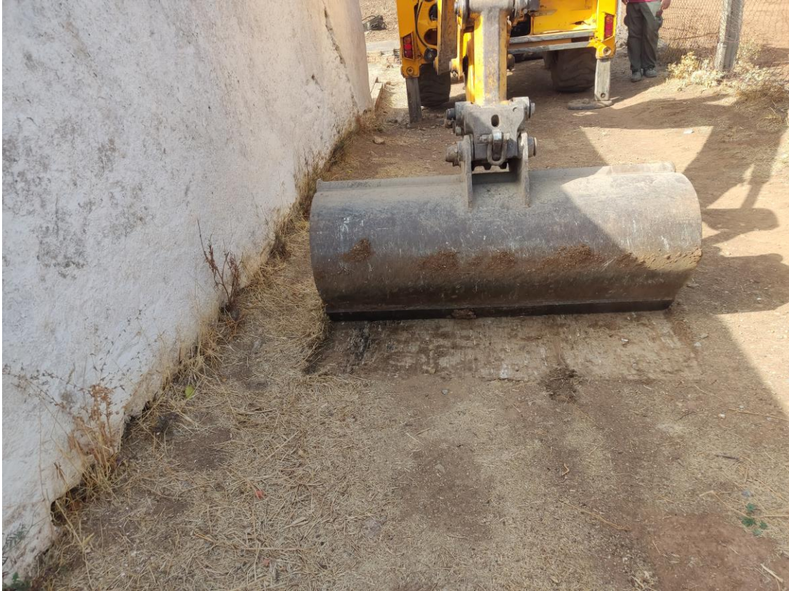
Foto. Detalle del inicio en el sondeo 6.2.
