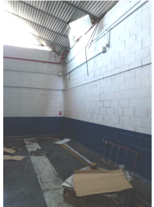
Interior de la nave donde cayó. Se observa lateral andamio que se usaba como escalera .
