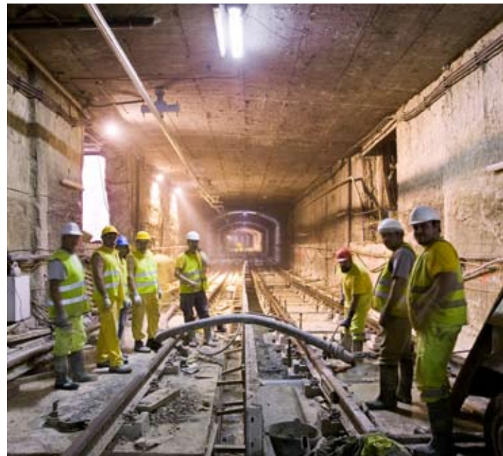
Obras en el sector de Amate, con uno de los viejos túneles al fondo.
