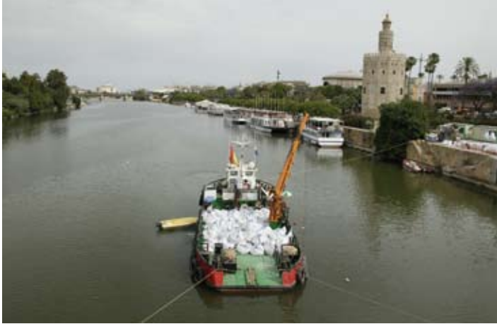
Operaciones con buzos para la colocación de una losa de hormigón en el lecho del río a su paso por Sevilla.
