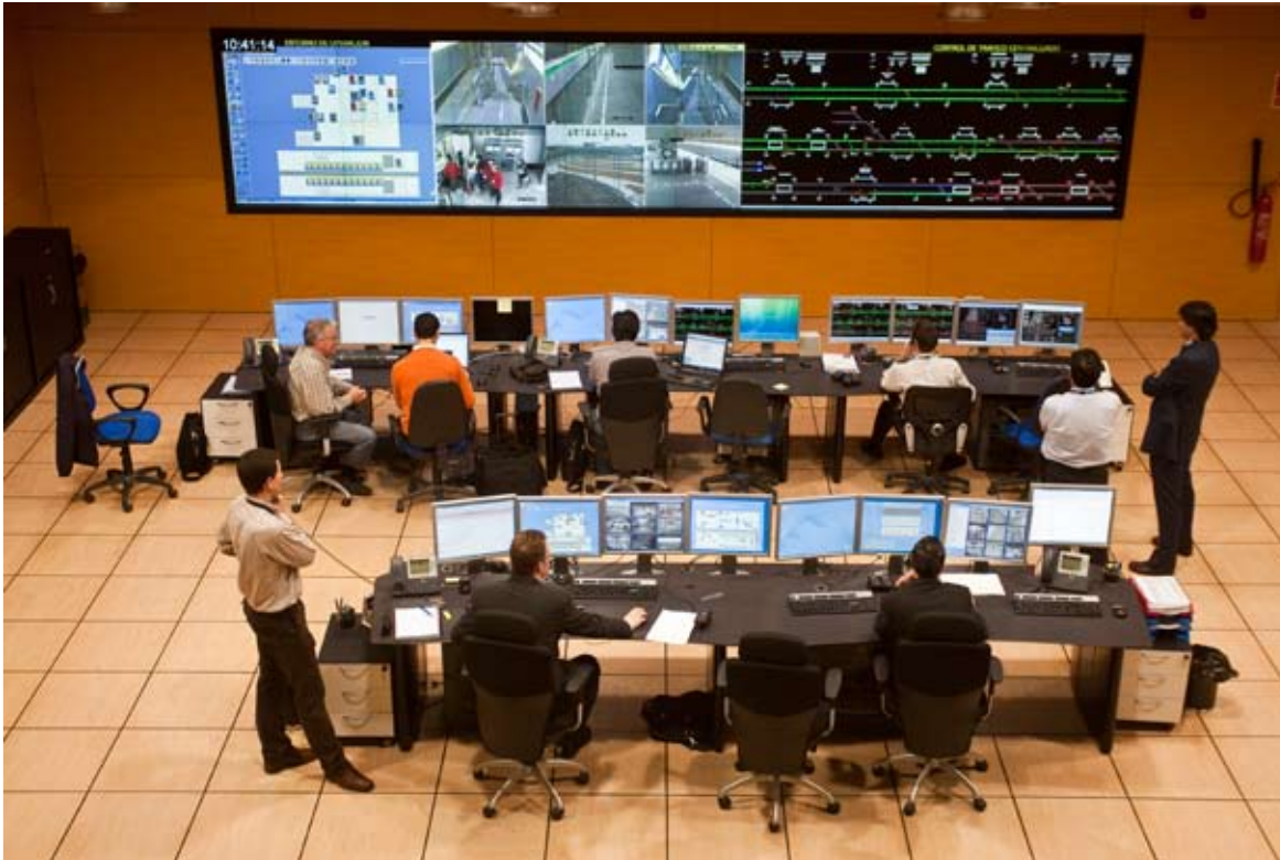
Puesto de Control Central y Control de Estaciones.
