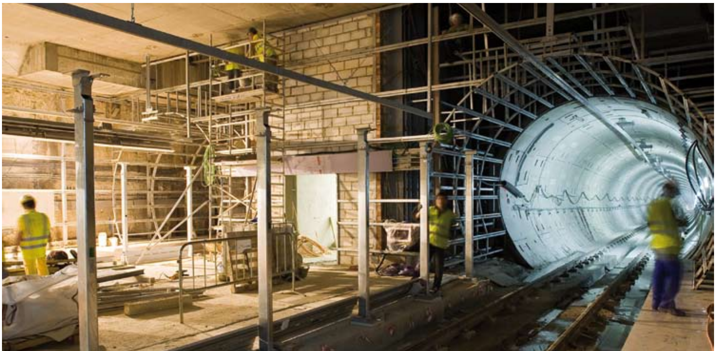
Imagen inferior: Construcción de la estructura de paso sobre el río Guadalquivir entre San Juan de Aznalfarache y Sevilla.
