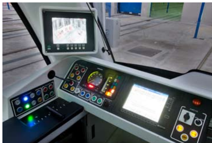
Cuadro de mandos en la cabina de un tren de Metro de Sevilla.
