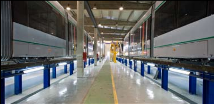
Imagen izquierda: Instalaciones de la Nave de Cocheras y Talleres de Metro de Sevilla.
